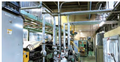
蒸気配管等の放熱対策による使用電力量の削減
