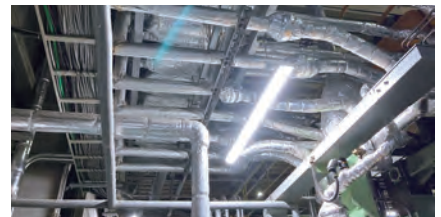
蒸気配管等の照明のLED化やセンサーライト化による使用電力量の削減
