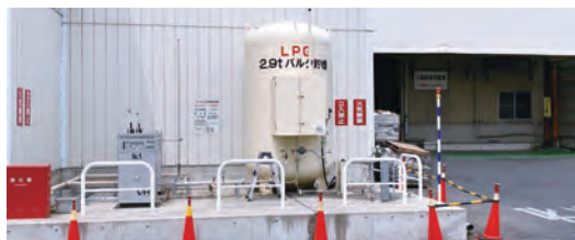
CO 2 ばい煙削減につながったLPガスボイラータンク
