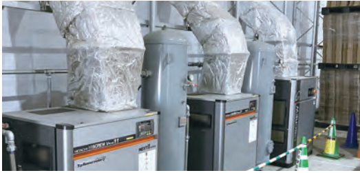
コンプレッサーの集約でエネルギー効率改善
